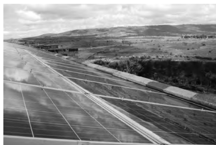
Kenias zweitgrößte PV-Anlage, finanziert durch die Diözese Rottenburg-Stuttgart
