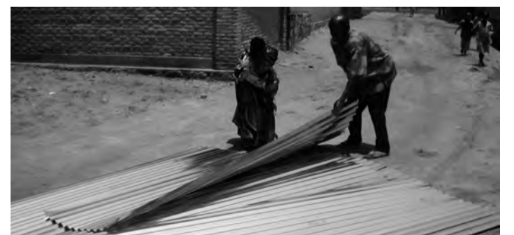
Neues Dach über dem Kopf: Diözese hilft beim Häuserbau für Flüchtlinge in Burundi, die Opfer einer Hochwasserkatastrophe geworden sind (Foto: P. Benno Baumeister)
